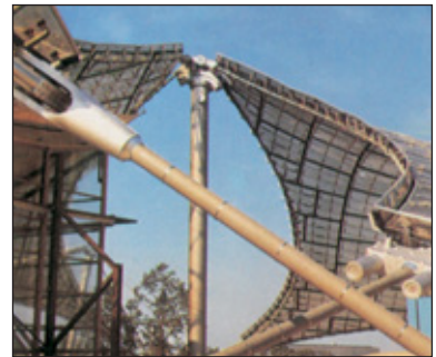
Bild 3: Seilverankerungen und Umlenkelemente aus Stahlguss G20Mn5
